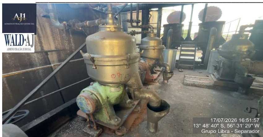
Figura 18 – 4 unidades da separadora centrífuga estrutura aco inox 60 m3 mca alfa laval mod fesx-512-34-60
