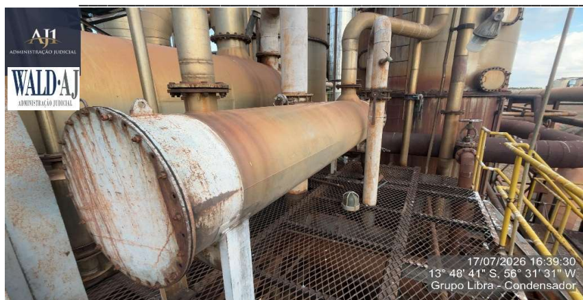
Figura 38 – Condensador Estrutura Em Aco Inox Cap 48 M2 Diam 1300x4000 Mm Mca Conger
