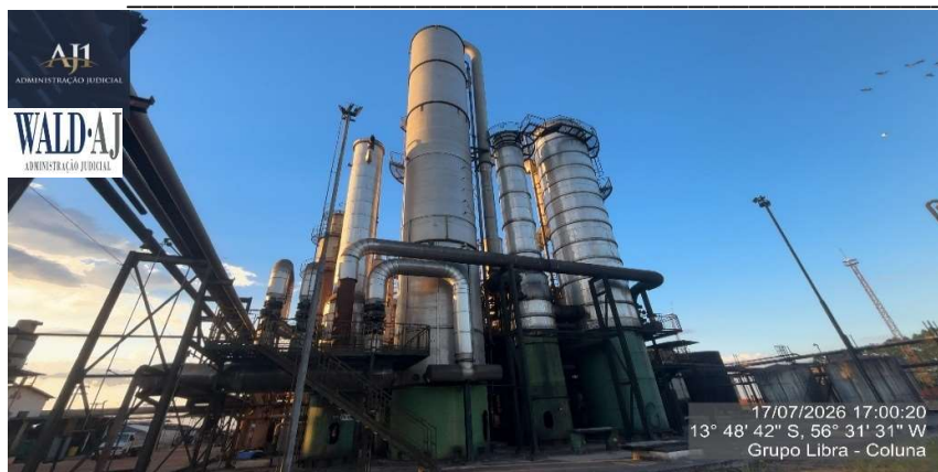
Figura 26 – Coluna de destilação estrutura aço inox dim 4000x30000 mm cap 225935 kg m3/h mca imec
