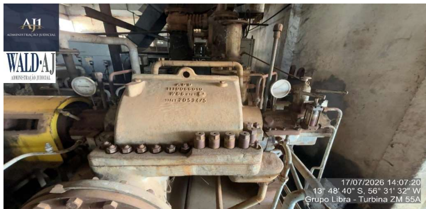
Figura 35 – Turbina Cap 2605 Kw Mca Abb Mod Zm-55ª
