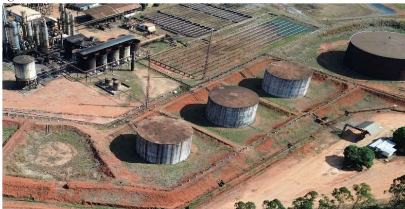
Figura 27 – 3 Unidades De Tanque Cilindrico Vertical P/Alcool Estrutura Em Aço Carbono Cap 5000 M3.
