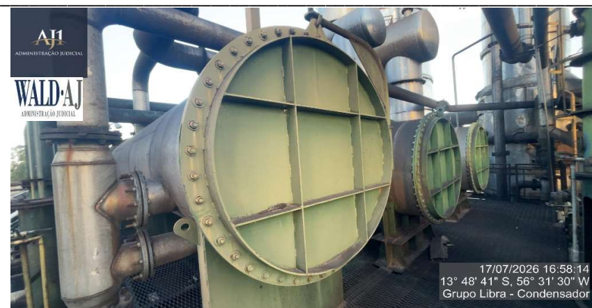
Figura 36 – 2 Unidade De Condensador Estrutura Em Aco Inox Cap 5-8 M3 Diam 1500x3300 Mm Alcool Mca Imec
