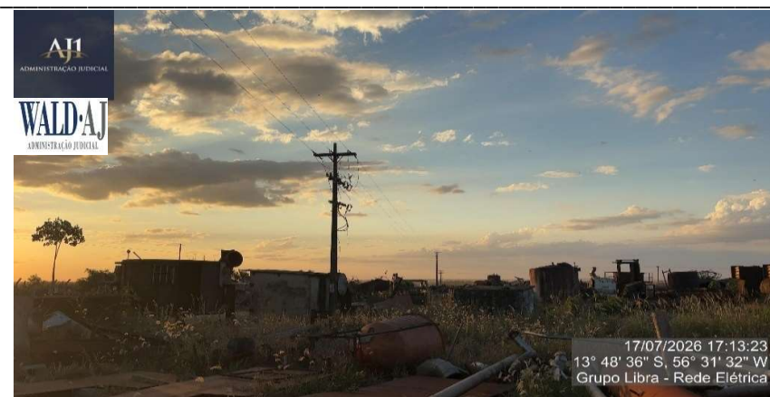
Figura 40 – Rede Elétrica De Alta Tensão C/Cabo Em Alumínio C/Alma Em Aco C/118 Poste(S) Em Concreto Alt 11000 M
