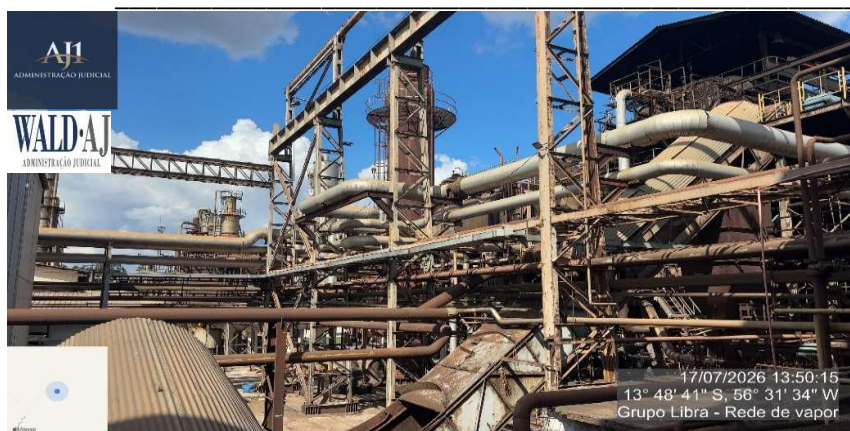
Figura 10 – Rede De Vapor C/Tubulação Em Aço Carbono Isolado Em Lã De Rocha Revestido Em Chapa De Alumínio C/Dia
