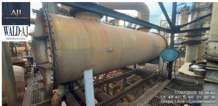
Figura 43 – Condensador Auxiliar Estrutura Em Aco Inox Cap 72 M2 Diam 1200x4000 Mm Mca Conger
