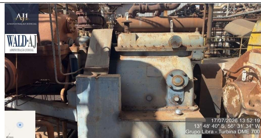
Figura 24 - Turbina Pot 865 Hp Mca Sebturbinas Mod Dme 700
