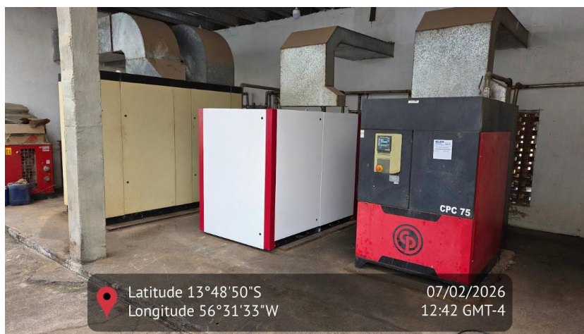
Imagem dos compressores de ar
