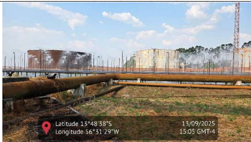
Figura 1635 - Imagem do sistema de resfriamento da unidade
