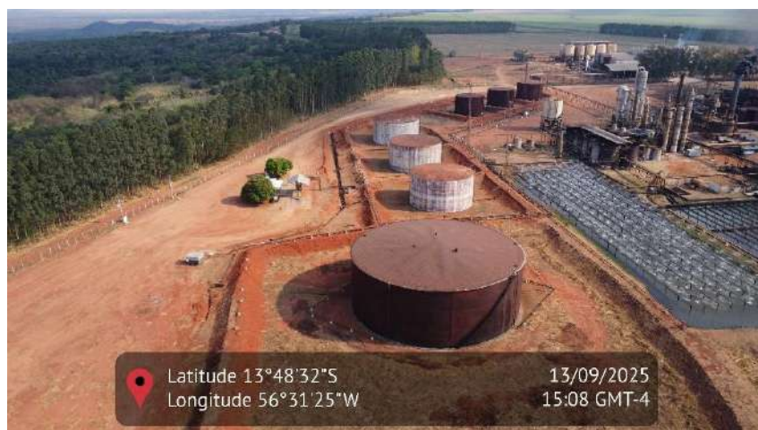
Figura 16062 - Imagem aérea dos reservatórios de etanol produzido
