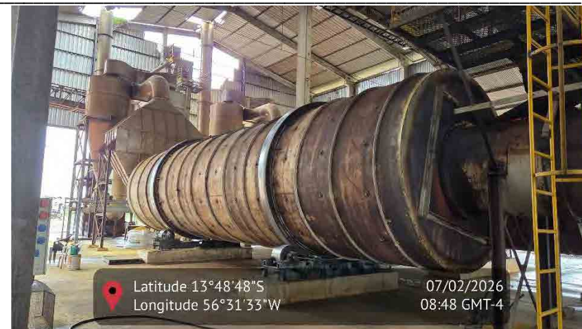
Figura 188 - Imagem da caldeira em funcionamento
