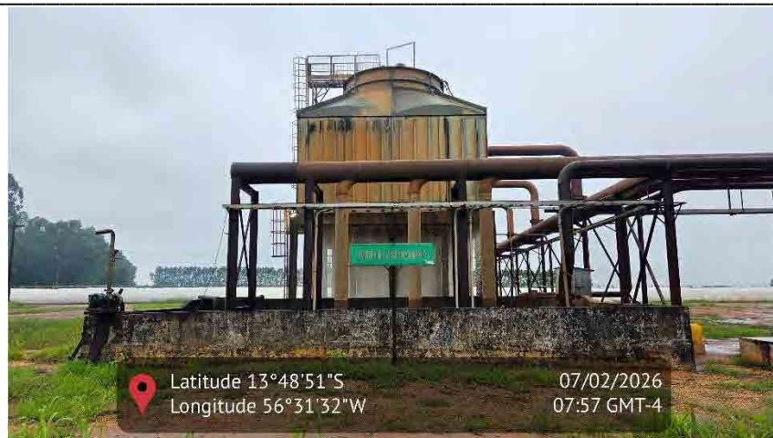
Figura 194 - Imagem da torre de resfriamento
