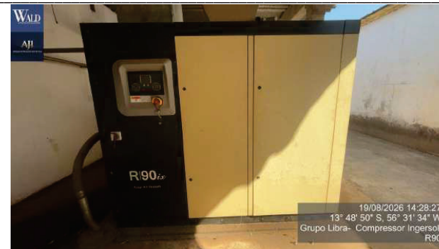
Figura 69 – compressor de ar tipo parafuso rotativo c/ motor potencia 125cv mca ingersoll rand mod r 90kw
