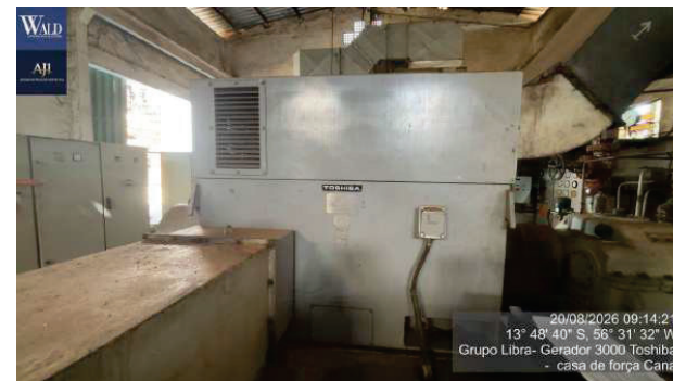
Figura 78 – gerador síncrono pot 3000 kva mca toshiba mod galt
