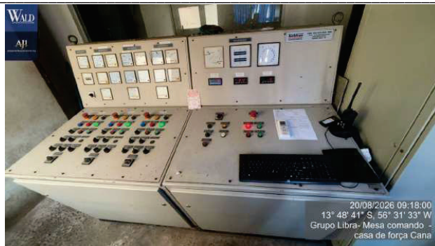
Figura 79 – mesa de comando estrutura em aço carbono c/3 indicadores c/20 indicadores analógicos c/15 lampadas c
