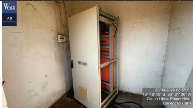
Figura 75 – pannel elétrico do hilo estrutura em aço carbono c/2 porta(s) dim 1600x800x2100 mm c/1 inversor(a) d
