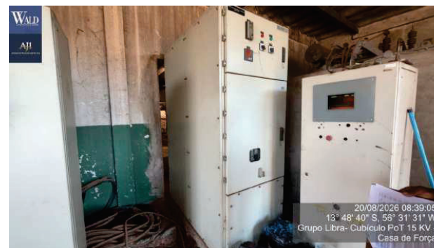
Figura 74 – cubiculo c/1 disjuntor pot 15 kv mca cfm
