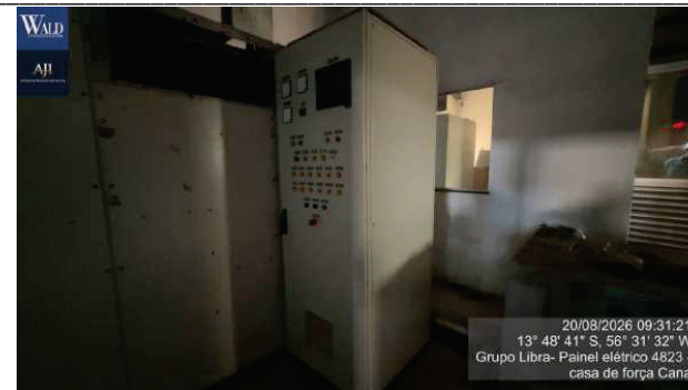
Figura 81 – painel elétrico c/1 porta(s) dim 800x800x2000 mm c/1 rele de proteção mca scheider
