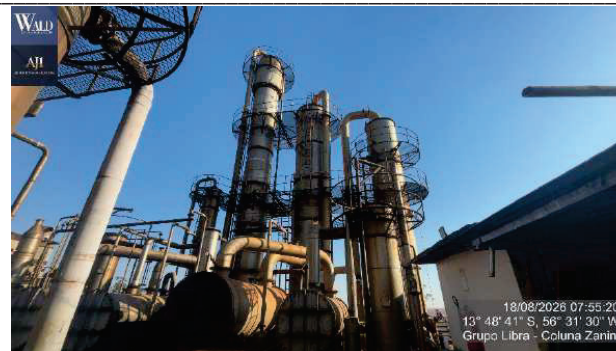
Figura 1 – 4 Unidade de coluna de destilação estrutura aco inox dim 3000x13000 mm cap 150000 l/24l m3/h mca zanini
