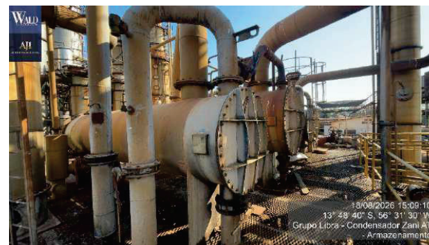
Figura 30 – condensador estrutura em aco inox cap 150000l/24 h diam 1400x6000 mm mca zanini mod zani-at
