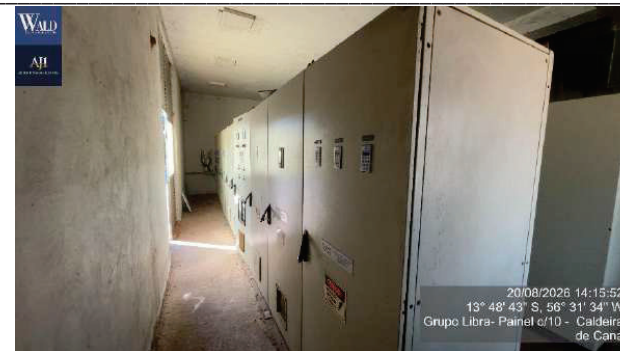
Figura 97 – painel eletrico estrutura em aco carbono c/10 porta(s) dim 8000x800x2100 mm c/1 chave(s) geral c/18
