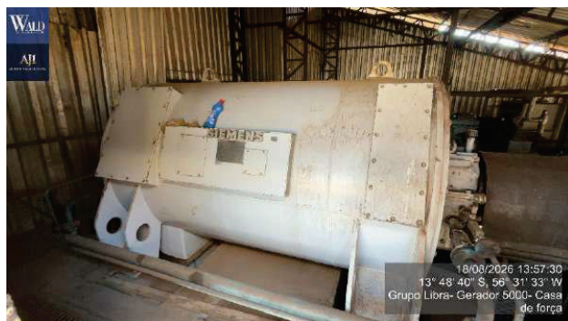
Figura 24 – gerador sincrono pot 5000 kva mca siemens mod 1fj1 804-4hc20-z
