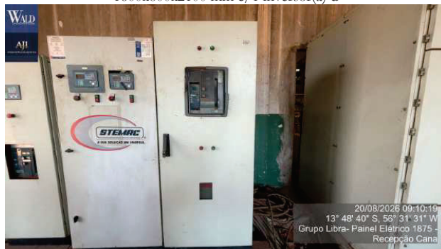
Figura 76 – pannel elétrico estrutura em aço carbono c/1 porta(s) dim 800x600x2000 mm c/1 disjuntor cap 1200 a
