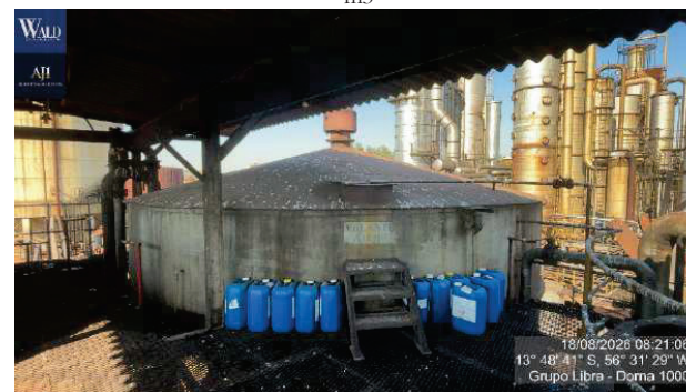
Figura 6 – 1 Unidade de dorna estrutura em aco carbono vertical cilindrico cap 1000 m3
