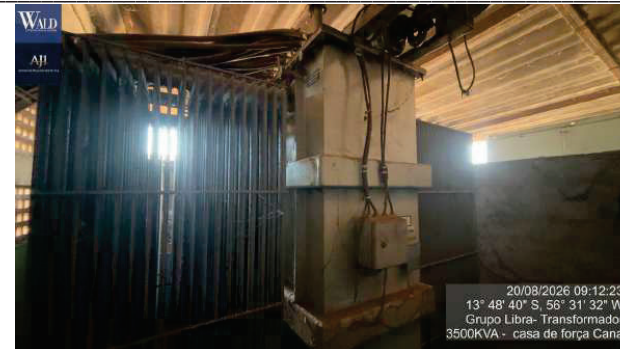
Figura 77 – transformador de força pot 3500 kva tensao 13800/440 v
