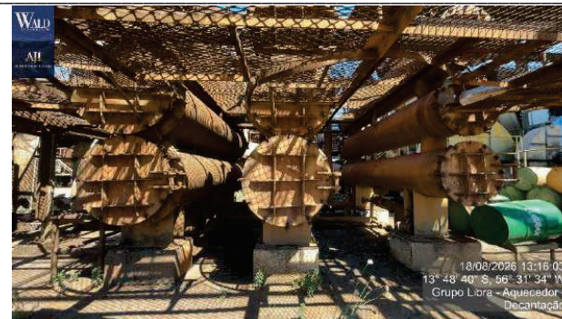
Figura 9 – 3 Unidade de aquecedor cilíndrico horizontal triplo do vinho/caldo 01 estrutura em aco carbono dim 1100x4000 mm
