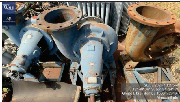
Figura 91 – bomba centrífuga vazao 1000 m3/h diam rotor 600 mm mca equipe mod eq-350-35
