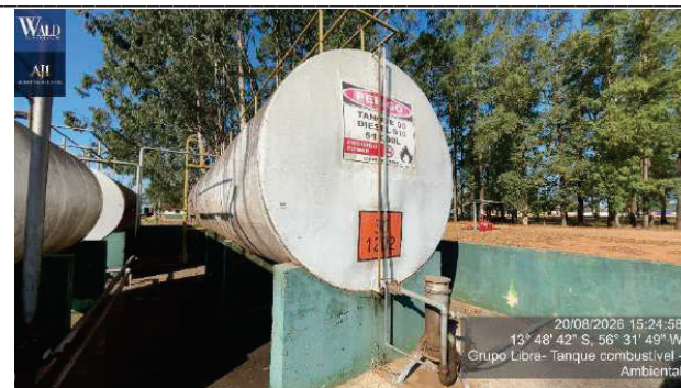
Figura 105 – tanque cilíndrico horizontal p/combustível estrutura em aço carbono cap 55 m3
