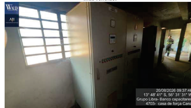
Figura 82 – banco de capacitores c/12 capacitor(es) pot 170 kvar mca turbtron
