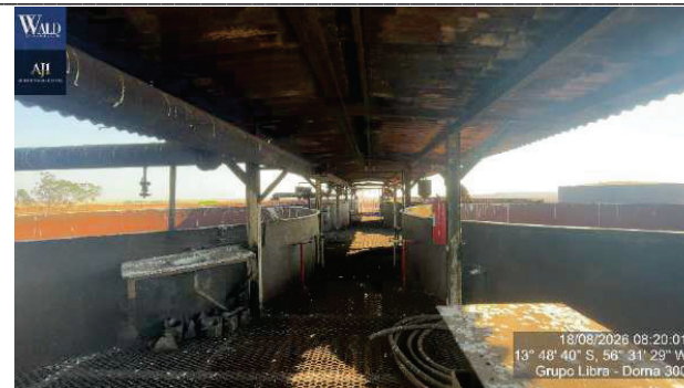
Figura 5 – 9 Unidade de dorna estrutura em aco carbono vertical cilindrico cap 300 m3
