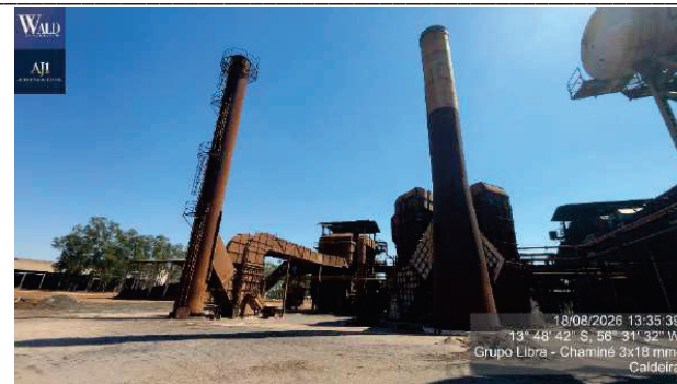
Figura 17 – 2 Unidade de chamine metalica dim diam 3500x18000 mm
