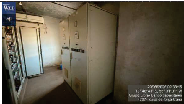
Figura 83 – banco de capacitores c/12 capacitor(es) pot 170 kvar mca turbrton
