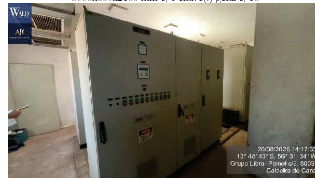
Figura 98 – painel eletrico estrutura em aco carbono c/2 porta(s) dim 1600x650x2100 mm c/1 ampermetro analogico
