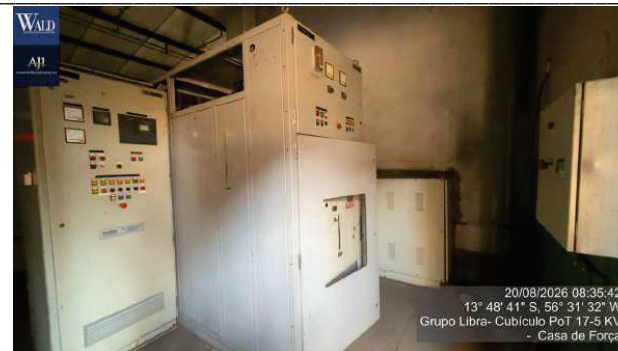
Figura 73 – cubiculo c/1 disjuntor pot 17-5 kv c/1 chave seccionadora mca Koblitz
