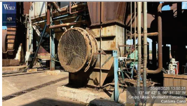
Figura 95 – 5 unidades de ventilador centrifugo vazao 2280 m 3 /h dim 3000x800x3000 mm mca lci ventiladores industriais mod pac.
