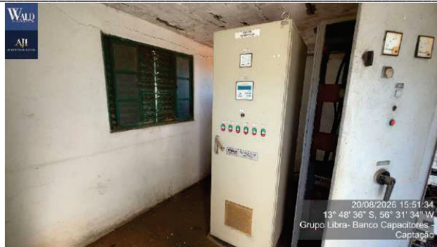
Figura 107 – banco de capacitores pot 75 kva mca turbtron
