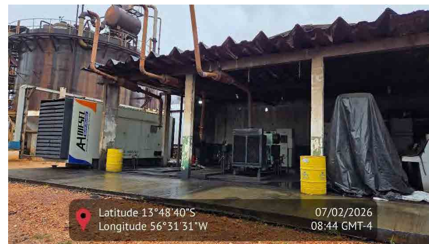
Figura 173 - Imagem dos geradores da usina
