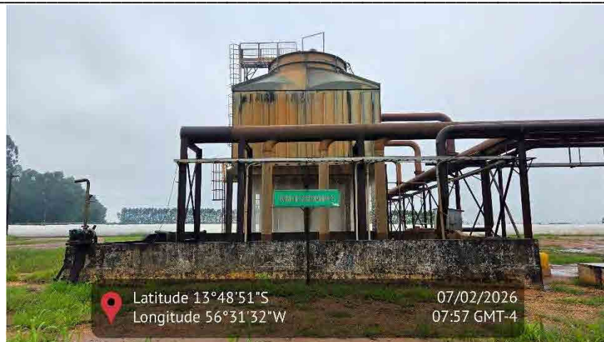
Figura 194 - Imagem da torre de resfriamento
