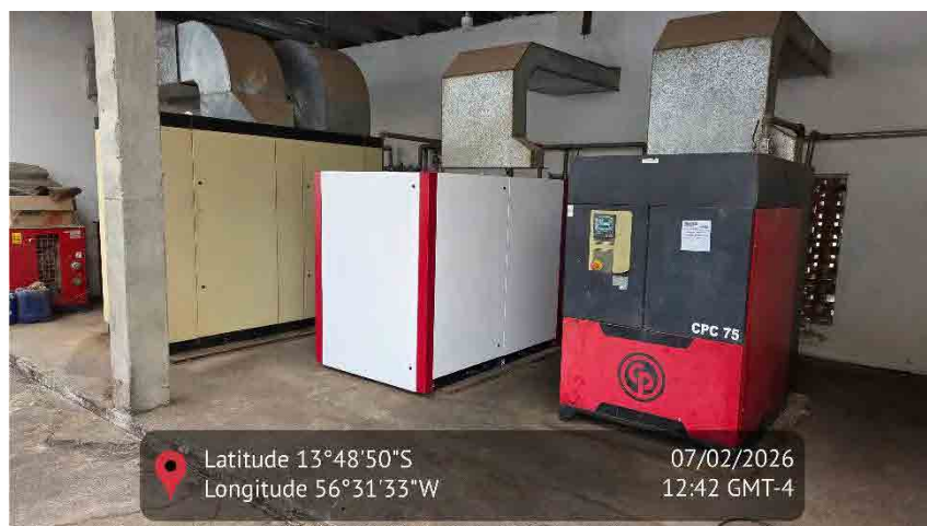
Figura 195 - Imagem dos compressores novos
