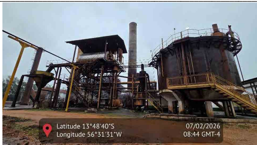
Figura 166 - Imagem da destilaria da usina
