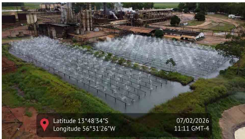
Figura 159 - Imagem aérea resfriadores da usina
