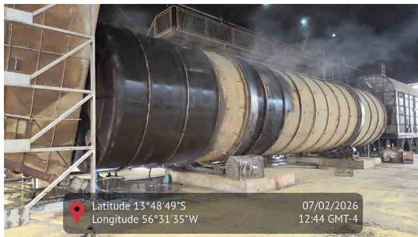
Figura 191 - Imagem da caldeira em funcionamento
