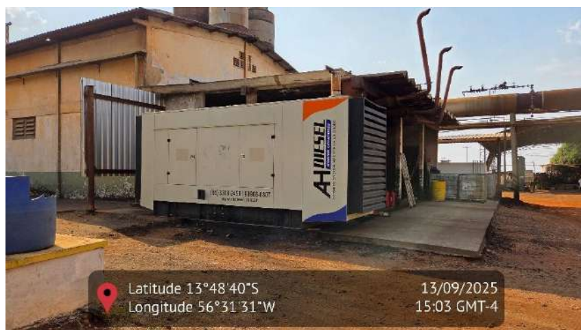
Figura 170 - Imagem do novo gerador energético da unidade
