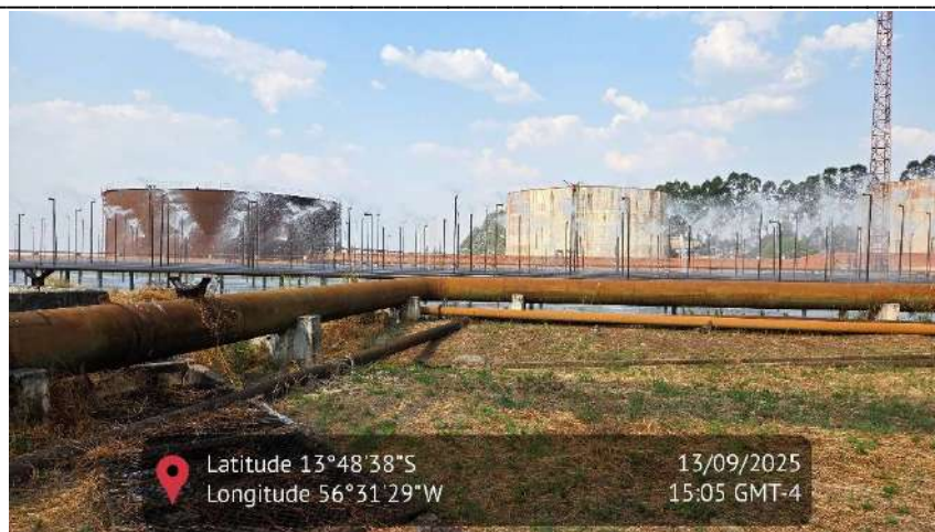
Figura 1635 - Imagem do sistema de resfriamento da unidade
