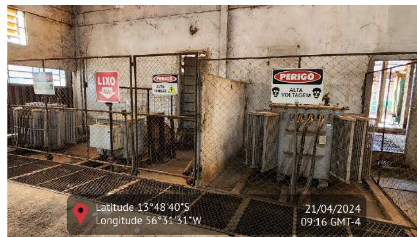
207 – Imagem dos transformadores de energia da usina (cana de açúcar)
