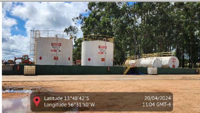
31 – Imagem dos reservatórios de combustíveis para uso interno
