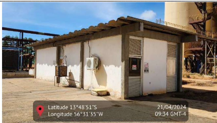
227 – Imagem da casa de força da usina de etanol (milho)
