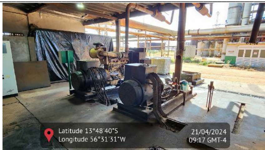
208 – Imagem dos geradores de energia da usina (cana de açúcar)
